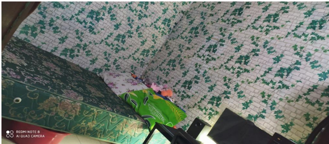
Kamar Informan utama yang tidak memiliki ventilasi udara
