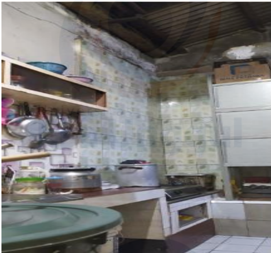
Dapur Informan utama yang tidak memiliki lubang asap/ventilasi udara
